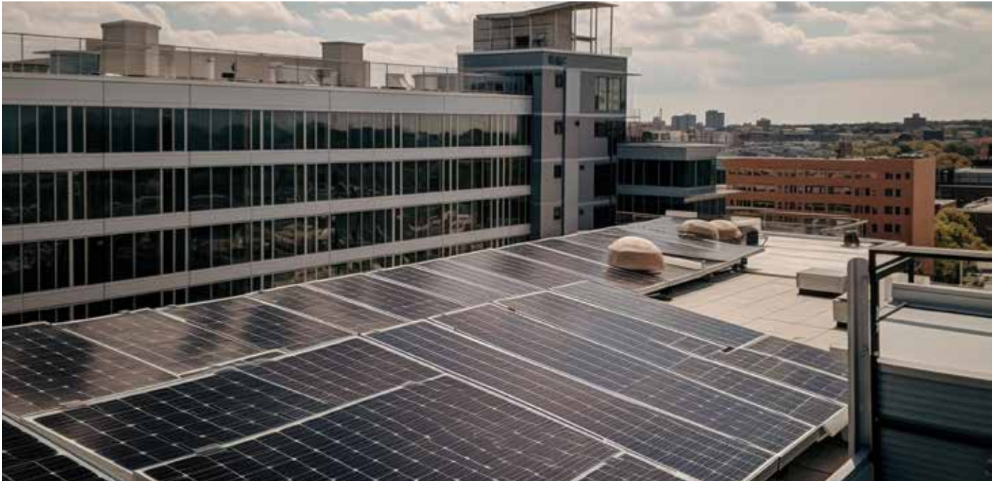
Impianto fotovoltaico per comunità energetica
