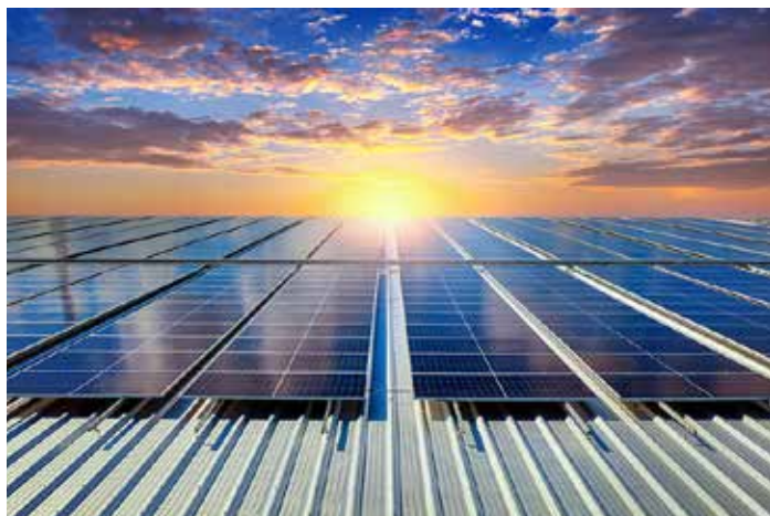
Impianto fotovoltaico a tetto
