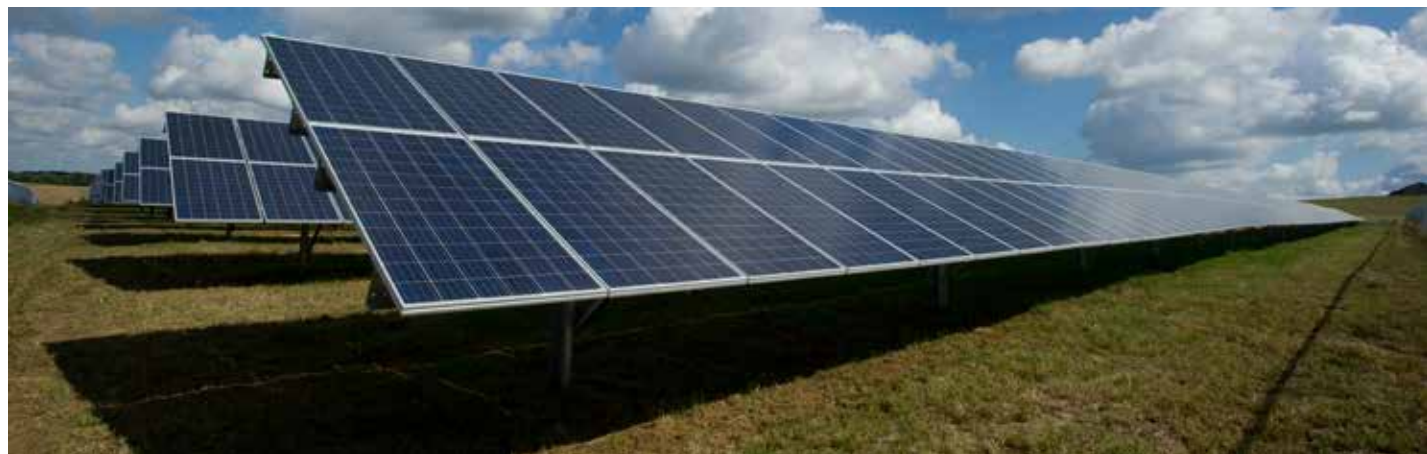
Impianto fotovoltaico a terra
